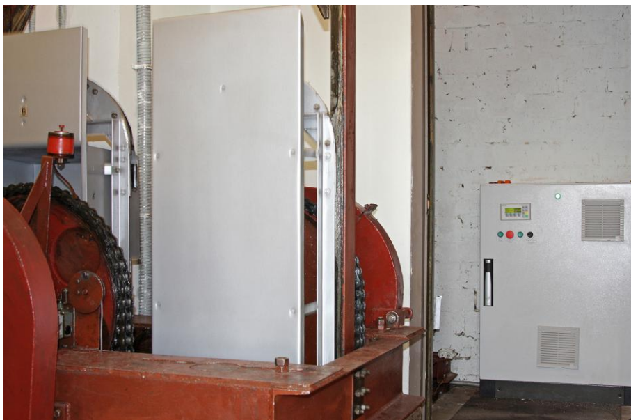
Рис.4 Вид машинного помещения, «Поликлиника №1» УДП РФ, г. Москва
